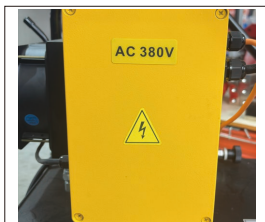
检查电控箱体，确定额定电压。
