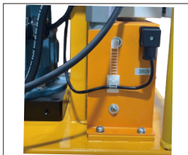
检查电控箱体，确定额定电压。
