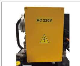
检查电控箱体，确定额定电压。
