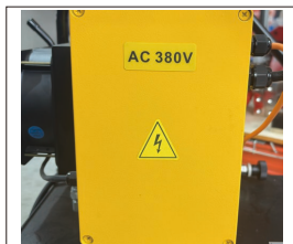
检查电控箱体，确定额定电压。
