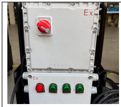
防爆电控箱，电机启动总开关。
