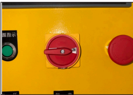
泵站电源总开关
