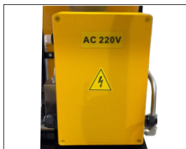
检查电控箱体，确定额定电压。
