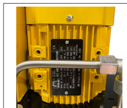
检查泵体铭牌。
